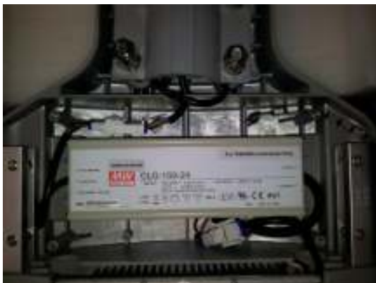
Figura 19 – Driver de acionamento. Fonte: ANGLOGOLD ASHANTI, 2012.
